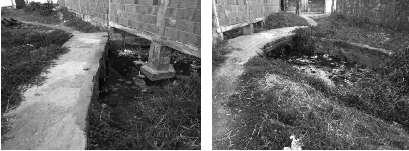
Figura 3 - Acúmulo permanente de esgoto e alagamento no período das chuvas, devido à falta de estrutura de drenagem e saneamento básico, especialmente em Nova Esperança (rua Bento), em destaque nas fotografias.
